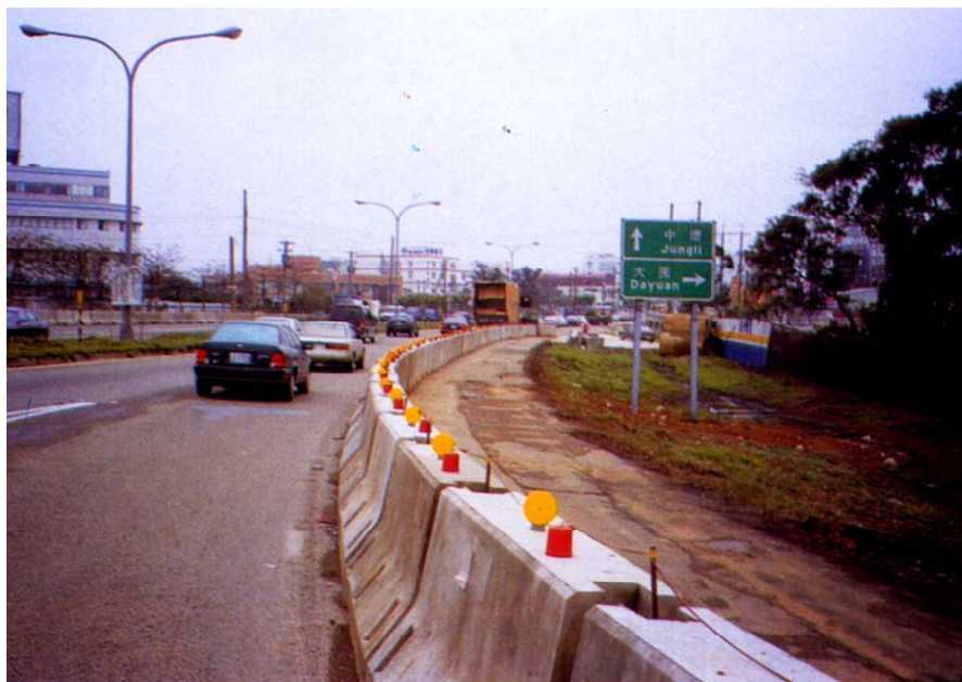
重要交通處所設置紐澤西槽化交通防止車輛闖入
