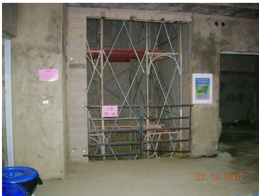
電梯間開口處設置欄杆與警語
