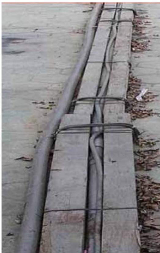
電器線配置於線槽內穿越車行通道
