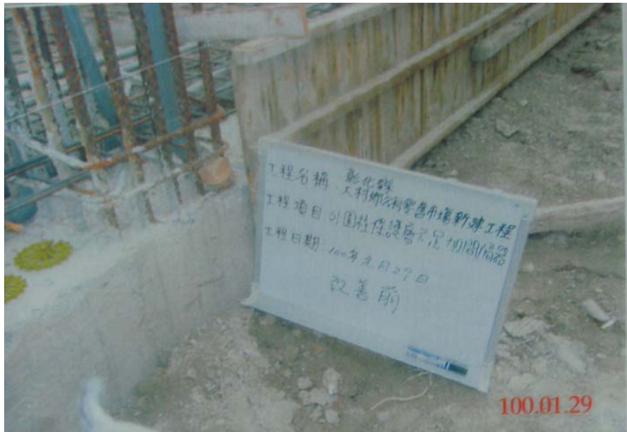
改善前：柱保護層不足 4 cm
