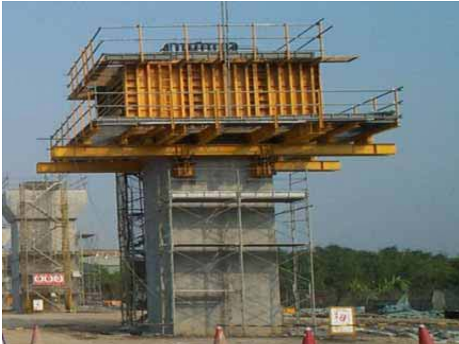
GIP 鋼管設置護欄
