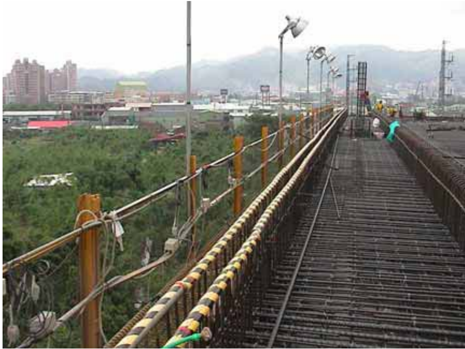
橋面板鋼筋頭用塑膠管保護，並加黃色警示帶，以免造成傷害
