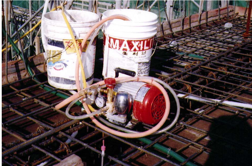
試壓臨時泵送設備
